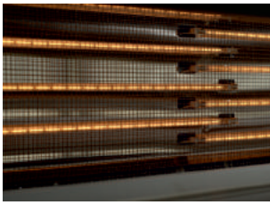
Séchage par infrarouge
